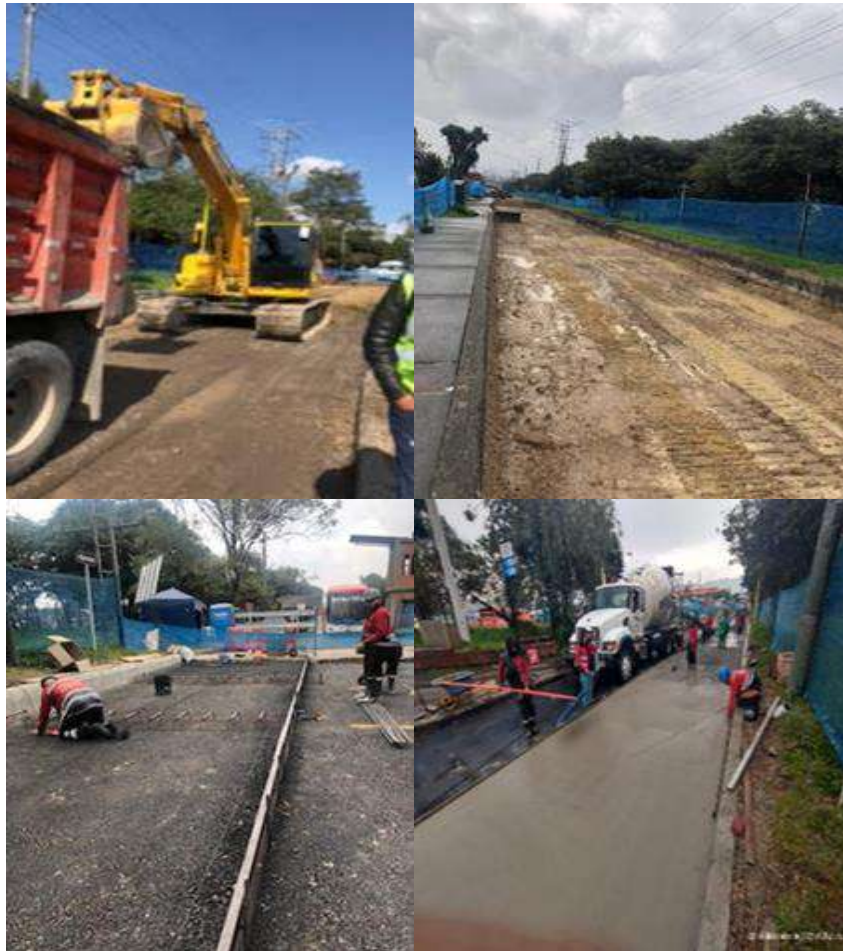
Ilustración 25. Obras de recuperación de 1600m 2 de malla vial en la Terminal Salitre
