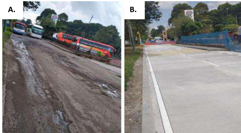
Ilustración 24. A. Antes de obras de recuperación de 1600m 2 de malla vial en la Terminal Salitre B. Tramo de recuperación de 1600m 2 de malla vial en la Terminal Salitre
